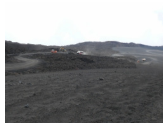
23.05.2017 12:32 Uhr An der nordöstlichen Basis des Monte Barbagallo. In der frischen und immer noch heißen Lava werden bereits wieder neue Wege für die Geländebusse angelegt.
